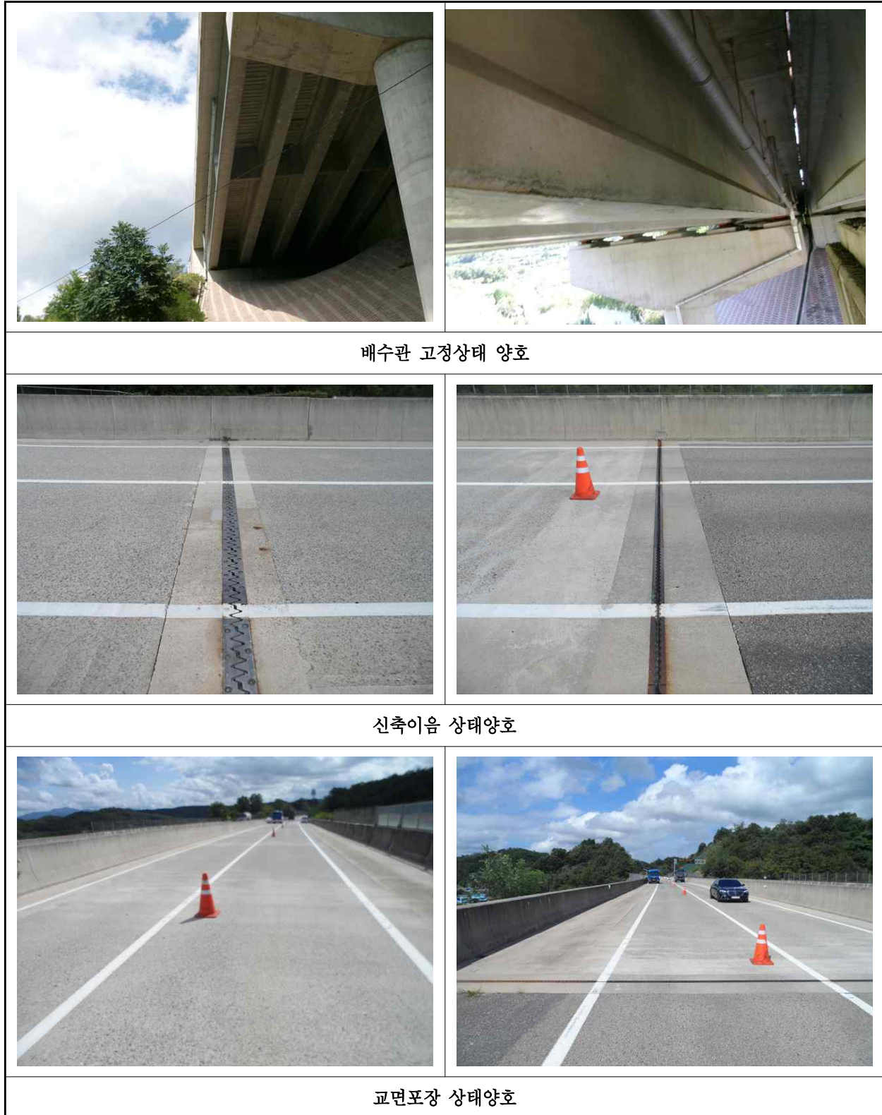
【사진 27.3.53】 교량의 공중이용시설 10대 위험요소 손상현황(계속)
